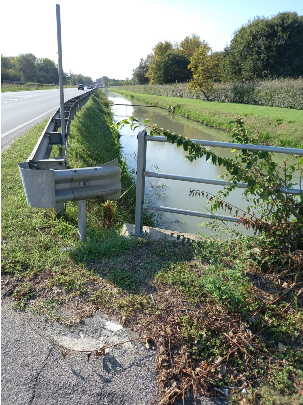
FIGURA 2 – PARTICOLARE DEI CEDIMENTI SPONDALI
