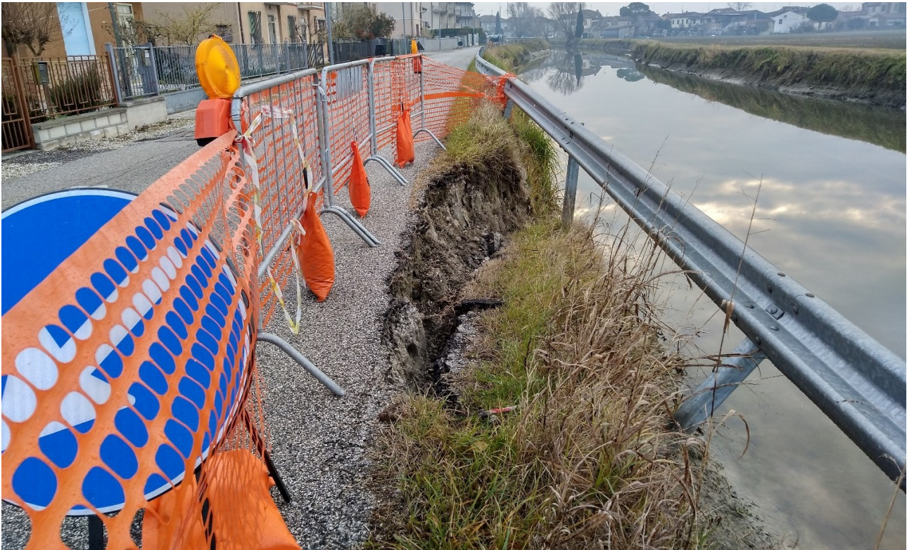
FIGURA - 2 – PARTICOLARE DEL CEDIMENTO SPONDALE
