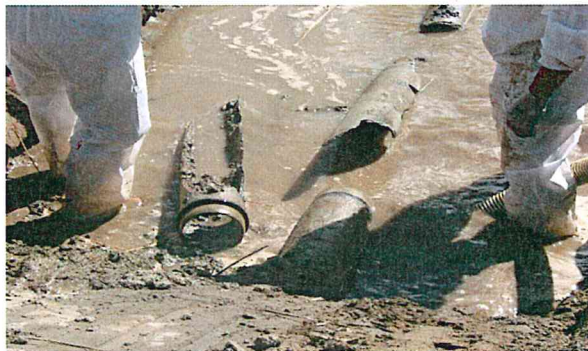
Particolare rottura - Tubo rotto con martello
