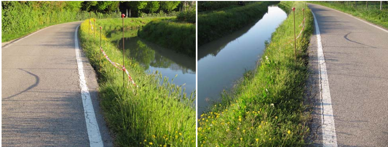
FIGURA - 2 – PARTICOLARI DEL CEDIMENTO SPONDALE
