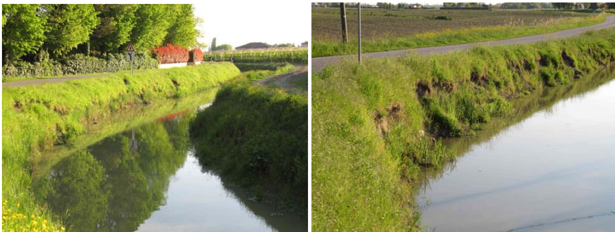
FIGURA - 3 – PARTICOLARI DEL CEDIMENTO SPONDALE
