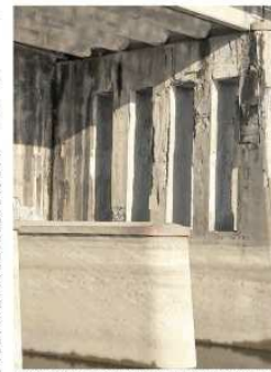
PERICOLO Sotto il ponte e sopra un dettaglio del degrado in cui versa
