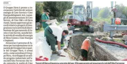
Tecnici di Hera al lavoro su una rete del gas. Il Gruppo punta ad assumere le reti dell'Alto Ferrarese
