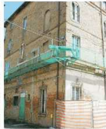
Dal "Palazzone" di Filo calano pezzi di strada, anche sulla ciclovia
