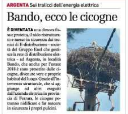
ARGENTA Sul traliccio dell'energia elettrica
