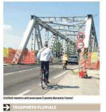
Un ciclista che attraversa il ponte durante i lavori. In basso: il servizio di traghettamento tra Santa Maria Maddalena e Pontelagoscuro. In questi ultimi giorni sono a conclusione i lavori per realizzare quella rampa di accesso ai pontili per chi usa il servizio di traghettamento.
