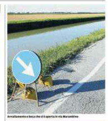
Avvallamento e buca che si apre in via Marabino.
