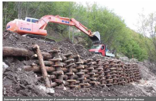
Intervento di ingegneria naturalistica per il consolidamento di un versante franoso - Consorzio di bonifica di Piacenza
