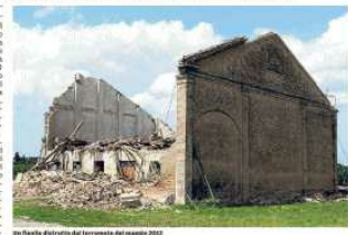
Un fienile distrutto dal terremoto del maggio 2012
