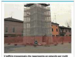
L'edificio trasformato che rappresenta un ostacolo per molti automobilisti che chiedono chiarezza sui tempi di recupero
