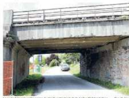
La parte del ponte sotto esame, la strada sottostante e via Argine Sinistro Volano
