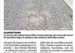
SAMPJETRINI La trama dei selciati di porfido è stata alterata nel corso dei lavori di ripristino dopo la chiusura del cantiere della fibra ottica
