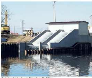
L'impianto realizzato nella conca di Valpigliaro sul Po di Volano
