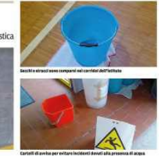
Secchi e altri contenitori nei corridoi dell'istituto
