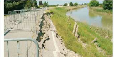
VORAGINE Lo smottamento di un tratto dell'argine in via comunale per Burana, chiusa al traffico
