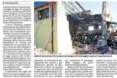
Vigili del fuoco di Ferrara e Piacenza metteranno in sicurezza la struttura così i consulenti potranno proseguire le indagini senza correre rischi
