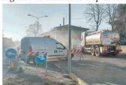
segnalazioni dei disagi si hanno, martedì sera, con i residenti che lamentano cali di pressione e mancata erogazione dell'acqua. Viene trovato un tubo staccato da un contatore, che viene ripristinato nella notte. Mercoledì però l'acqua ancora nelle case non arriva e i tecnici di Hera tornano, scavando per cercare la causa del problema che verrà risolto solamente nella serata di giovedì. L'acqua torna a rimpinguare i rubinetti e le caldaie per tutta la notte. Al mattino però, un altro guasto: si rompe una tubatura di dieci centimetri al civico 177 di via Cento, e ricominciano i lavori. Per riparare il guasto è stata inviata una
