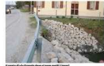
Spazio di via Gresolo dove sono scesi i laterizi
