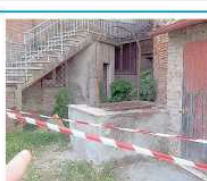
DANNEGGIATO L'area tramontata dopo la scorbifera dei giorni scorsi
