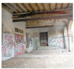
DEGRADO Uno scorcio del portico dell'ex convento di Santa Caterina Martire, in via Rovversella: confluisce col giardino dei Diamanti
