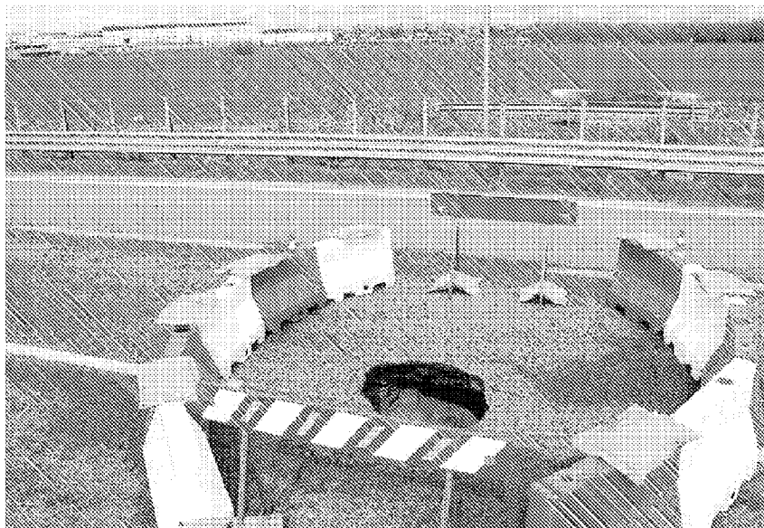
Il buco che si è aperto su una corsia della superstrada. In alto a destra le delimitazioni per il traffico
