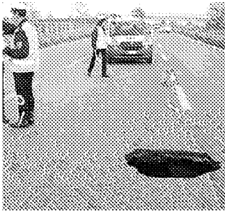
La buca in superstrada
