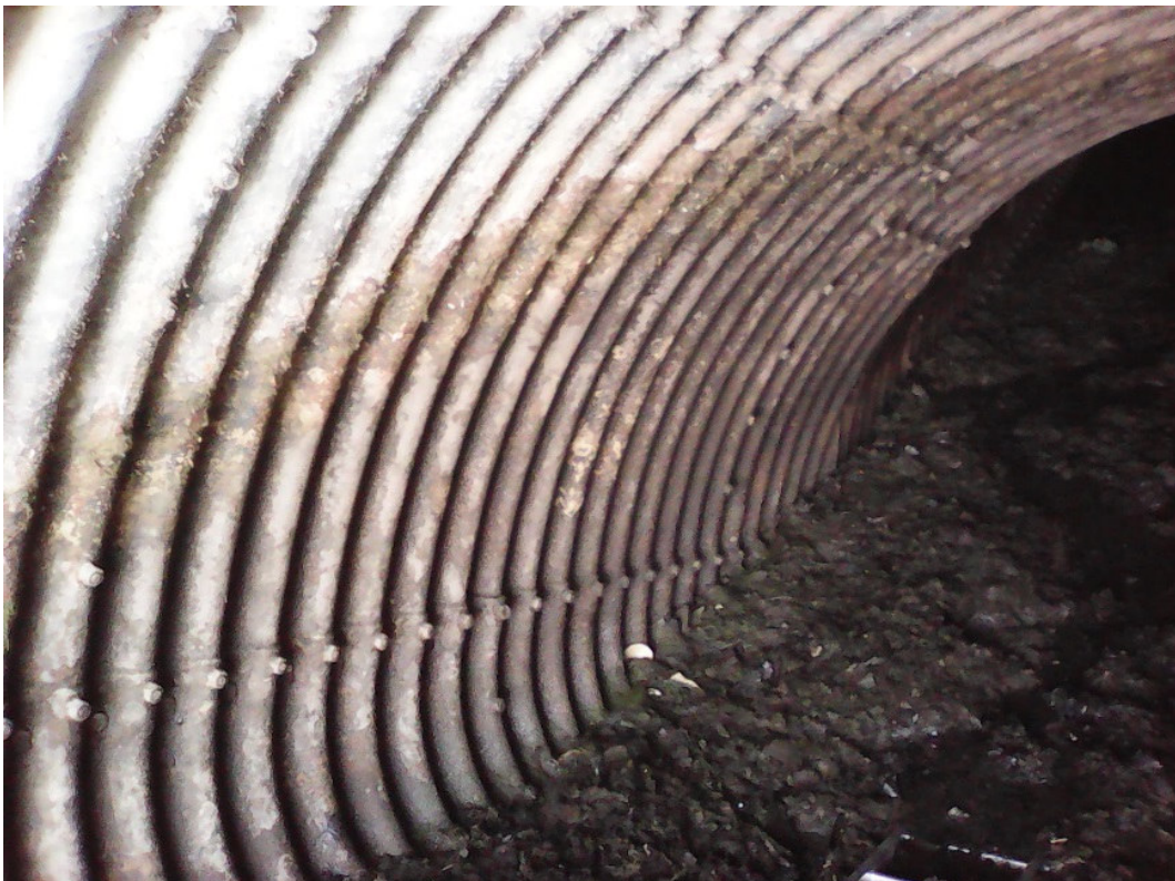
Figura 4: Tubo finsider sito in località Corporeno
