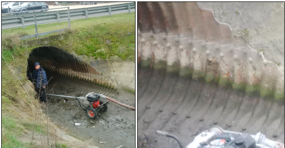
Figura 4: Foto dello stato di fatto del tubo da sostituire
