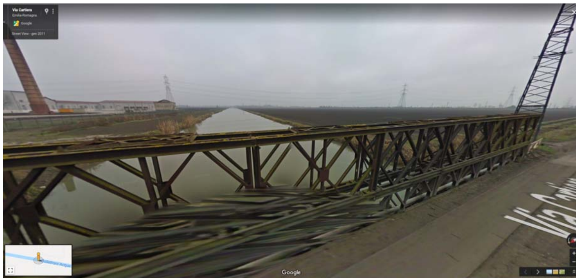
Figura 14. Individuazione del cavo protetto dell'ENEL interferente tra le sezioni 51F e 53 – Foto dal Ponte di via Cartiera verso valle.
