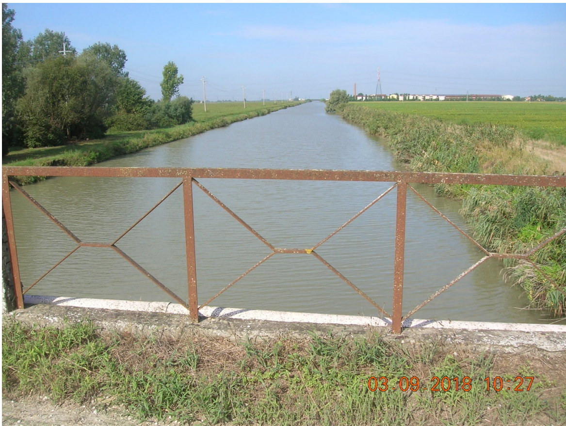
Figura 12. Individuazione del cavo protetto dell'ENEL, interferenza sita in destra idraulica tra le sezioni 52 e 55, foto dal ponte Lamberta.
